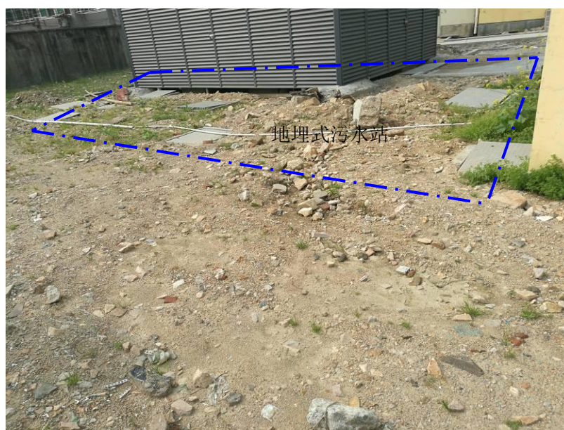
图 4-2 污水处理站照片
